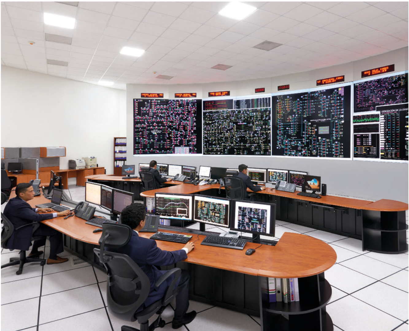
Fotografía 13. Sala de control del Centro Nacional de Control de Energía. | Centro Nacional de Control de Energía.
