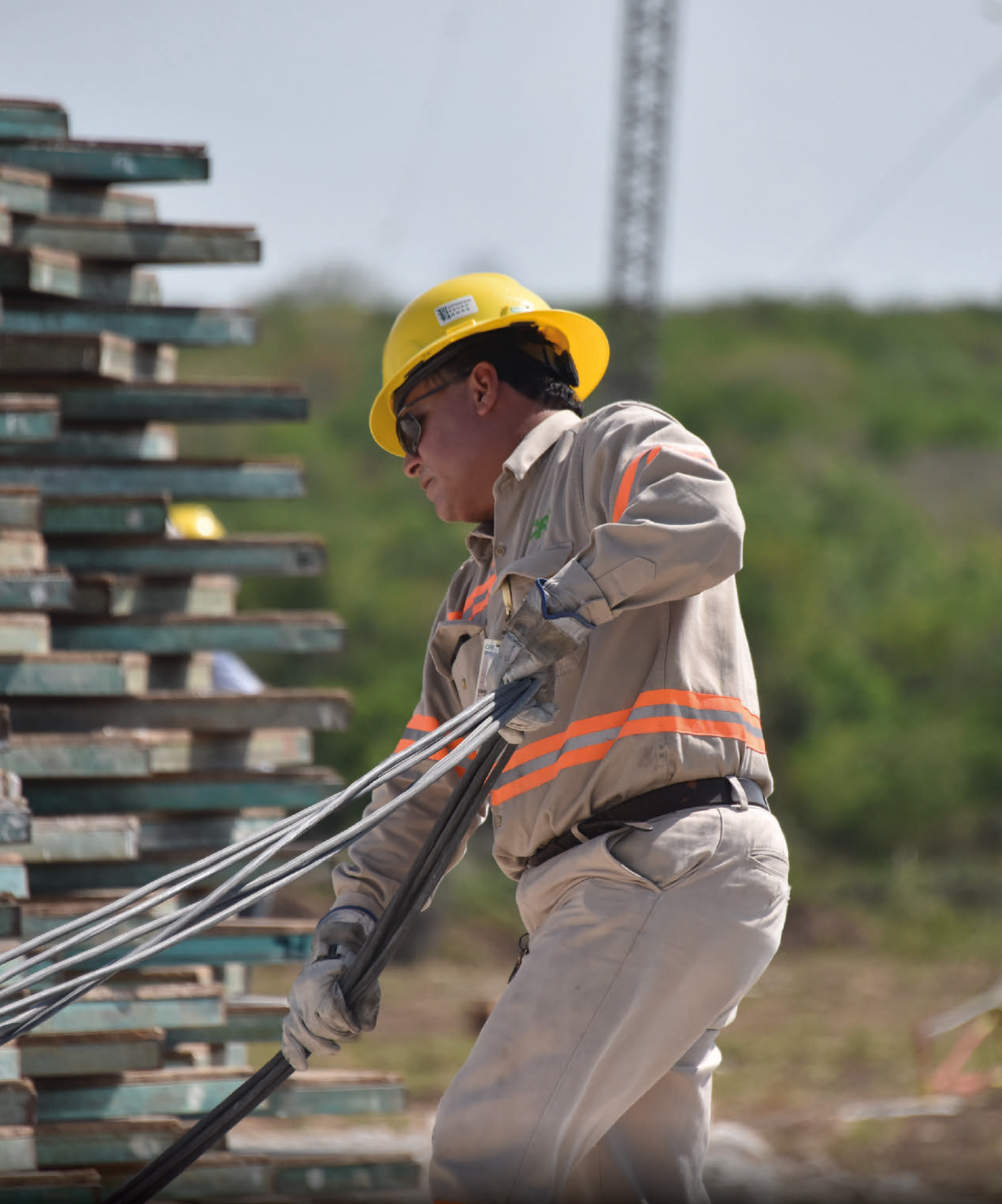
Fotografía 14. Maniobra para izaje de estructuras modulares de emergencia. | Comisión Federal de Electricidad.
