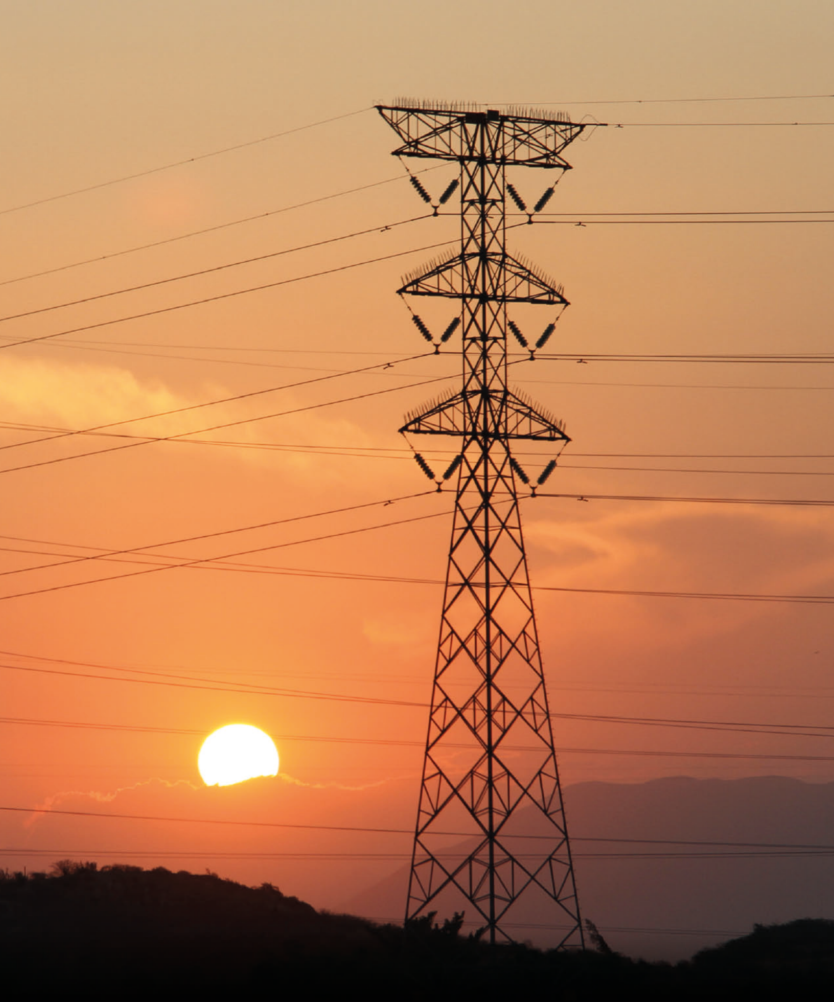
Fotografía 5. Torre de transmisión | Comisión Federal de Electricidad.
